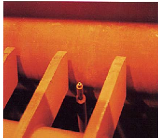
安装在热轧板材生产线辊道的导板间
